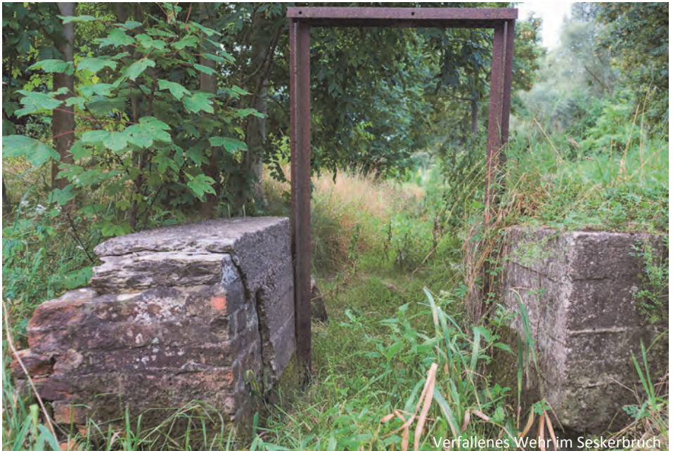
Verfallenes Wehr im Seskerbruch
