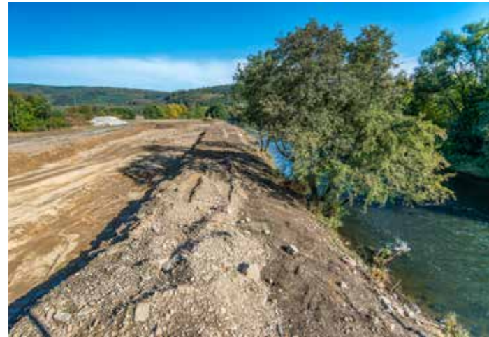
Oben: Die Baumaßnahmen der Renaturierung - für das Landschaftsbild eine klare Zäsur, für die Ruhr eine Befreiung
